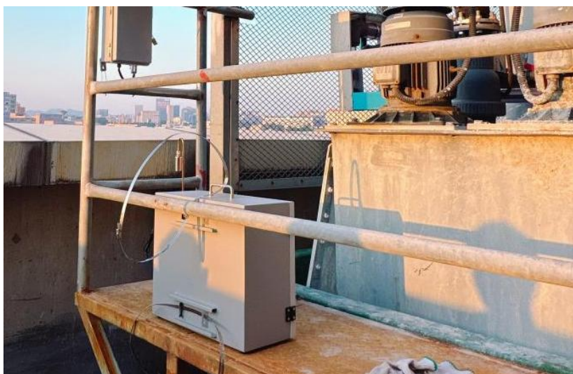
图 7 优泰 S1602 现场安装图
